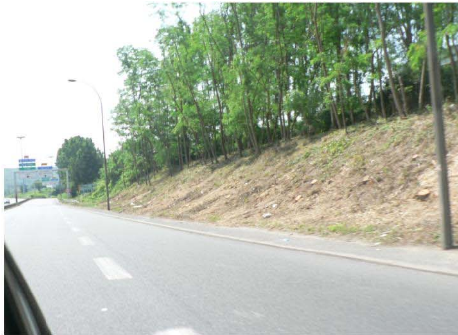
Talus en bordure de la RN 306
