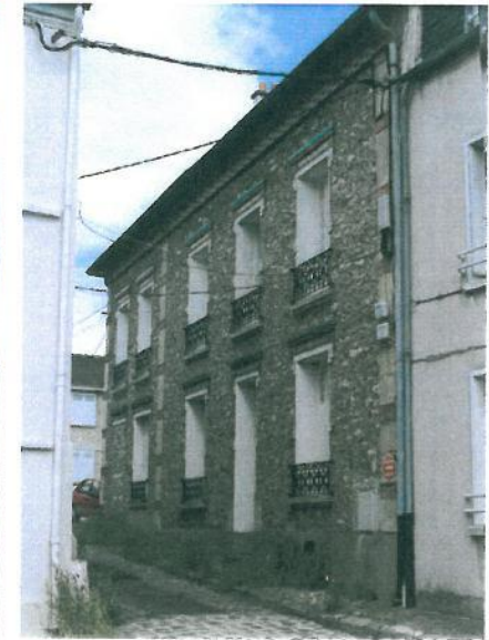
Autre exemple de parement en meulière associé à un décor brique et céramique
