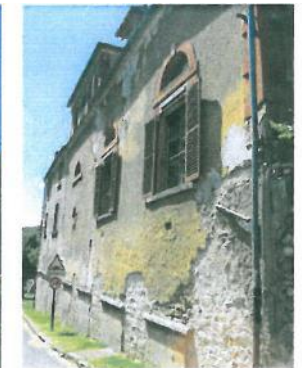
Enduit à la chaux et décor de brique rouge et pierre de taille
