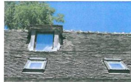
Lucarne sur le versant, rampante, maçonnée et châssis de toit en saillie peu intégrés à la couverture
