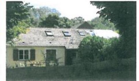
Châssis de toit en saillie et peu intégrés à la couverture
