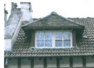
Les proportions de cette lucarne ainsi que les matériaux ne sont pas du tout adaptés
