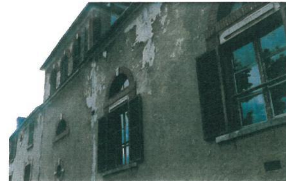
Exemple de menuiseries anciennes à restaurer
