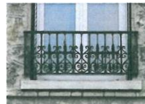
Garde-corps en applique
