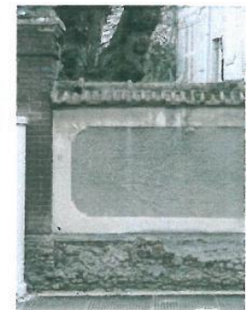
Mur de clôture maçonné compose avec l'ensemble des matériaux de la région : pilier en brique et pierre de taille. Soubassement en meulière, corps de mur enduit "à la tyrolienne" et couronnement de mur en tuiles mécaniques
