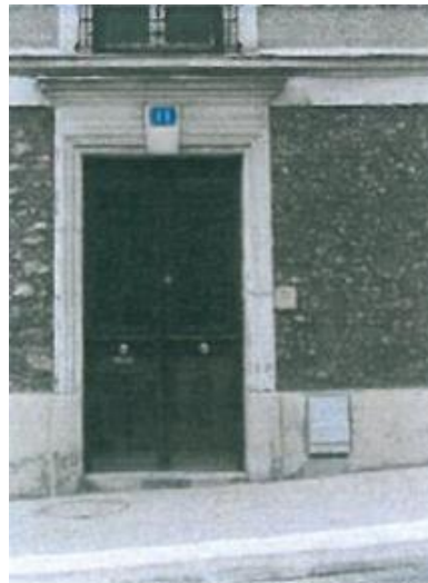
Exemple de coffret électrique visible en façade qui pourrait être dissimulé
