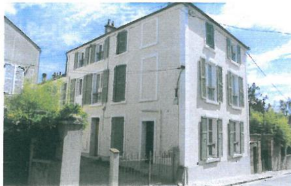
Les encadrements conservés des fenêtres bouchées (ou trompe l'œil ?) permettent de conserver visuellement l'harmonie de la façade et le rythme des ouvertures
