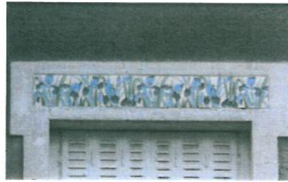
Incrustation en bande plate de carreaux de céramique
