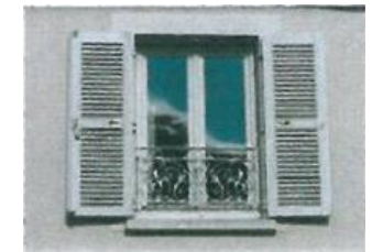
Contrevents persiennés d'origine à conserver et fenêtre en PVC à proscrire
