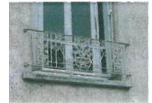
Garde-corps en applique
