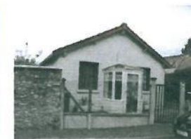
Enduit projeté néfaste pour le bâti ancien
