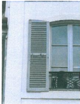
Contrevent à battant persienné épousant la forme de la baie en arc brisé
