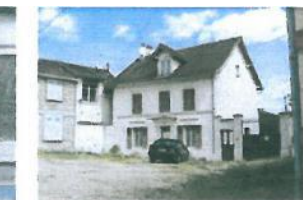
Enduit dégradé ciment, bande plate à la chaux naturelle et plâtre
