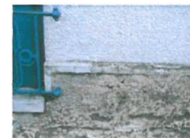
Enduit projeté inadapté associé à un soubassement en coquillage de meulière
