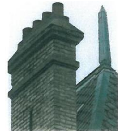
Cheminée en brique avec couronnement et cordon intermédiaire en saillie qui apporte une touche décorative. Ces souches s'harmonisent aussi bien avec les toitures en terre cuite qu'avec les toitures en ardoises comme ici
